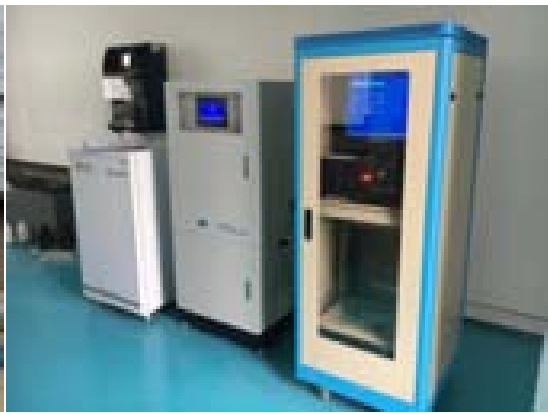
废水在线监测系统
