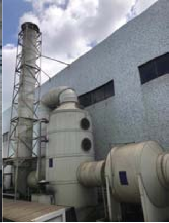
废气处理设施（其余电镀线）
