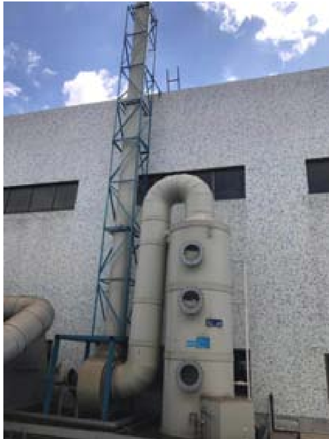
碱喷淋塔（盐酸雾、除油配套）
